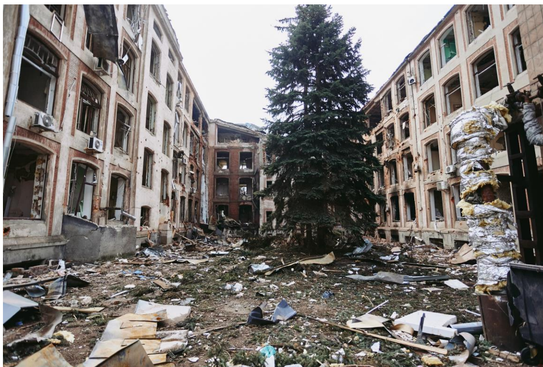
II. 5. Zniszczony budynek Wydziału Ekonomii Fot. W. Jakymenko.
